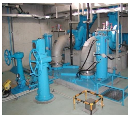
送水ポンプ室
