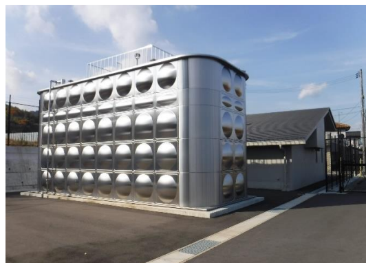
黒磯ポンプ所
