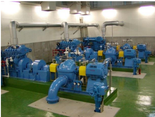
原水ポンプ室
