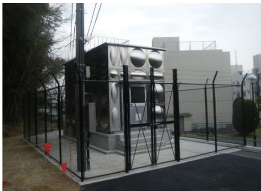
尾津一の谷団地ポンプ所
