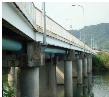
愛宕橋添架送水管
