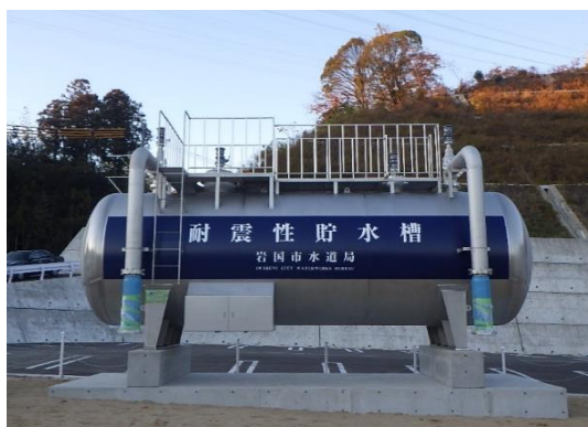
飲料水兼用耐震性貯水槽（山手庁舎内） （令和元年12月設置）
