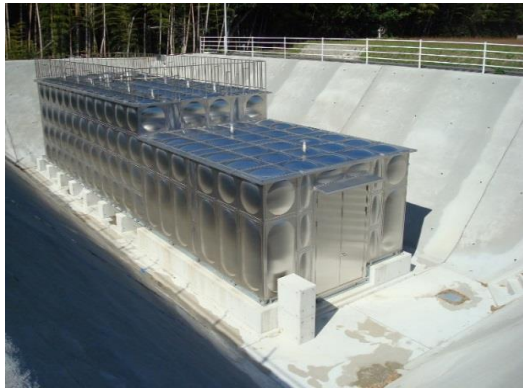
愛宕加圧設備
