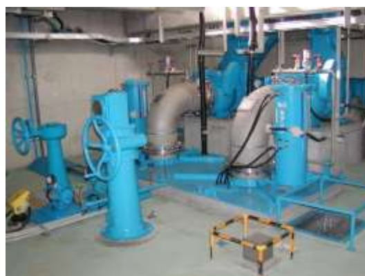
送水ポンプ室
