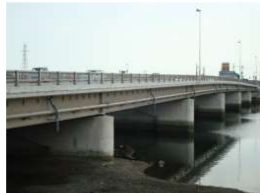
新寿橋添架配水管
