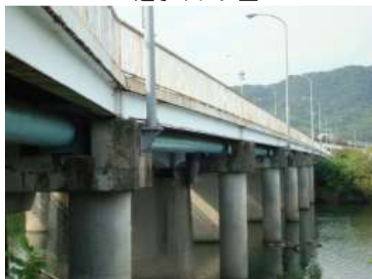
愛宕橋添架配水管
