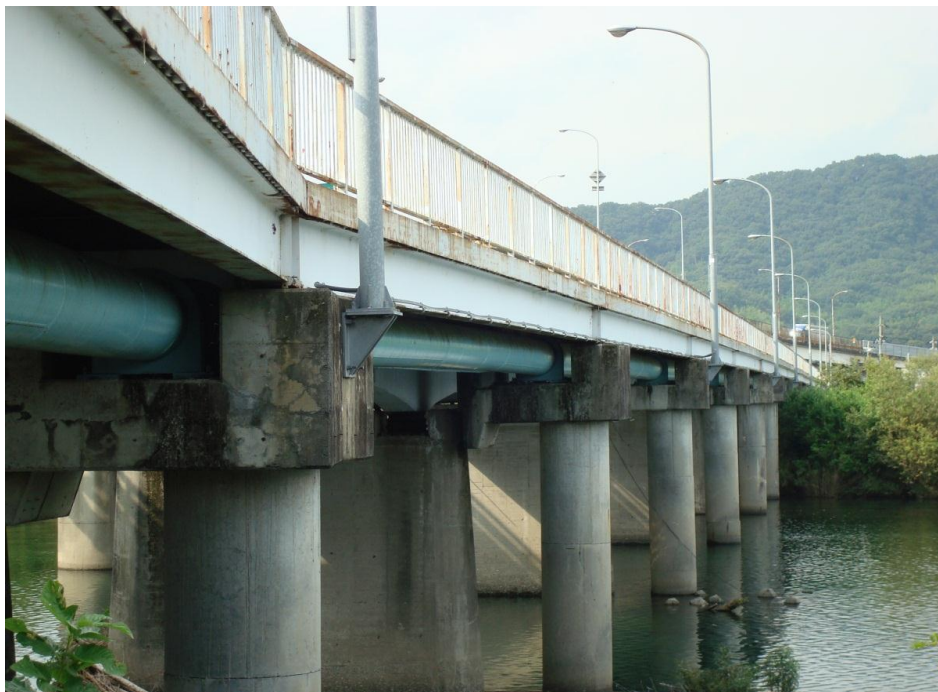
愛宕橋添架配水管
