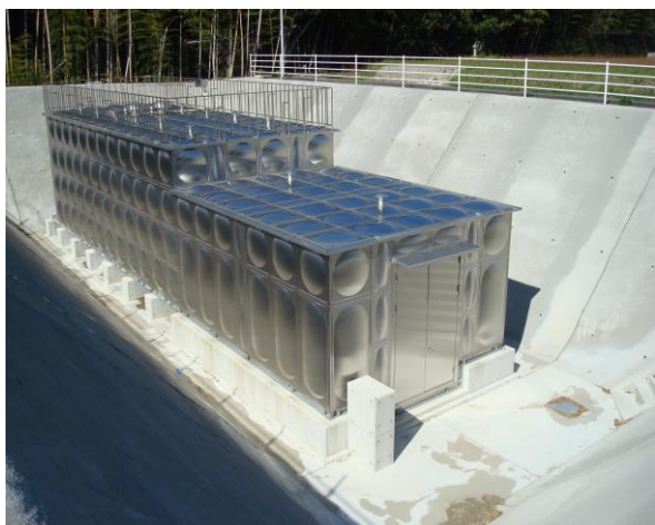
愛宕加圧設備
