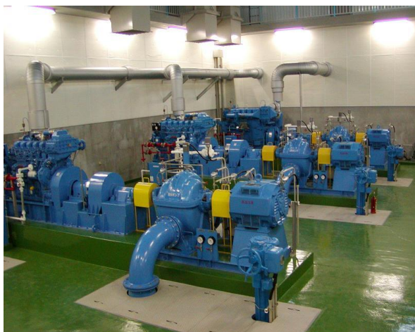
原水ポンプ室
