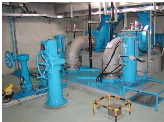
送水ポンプ室
