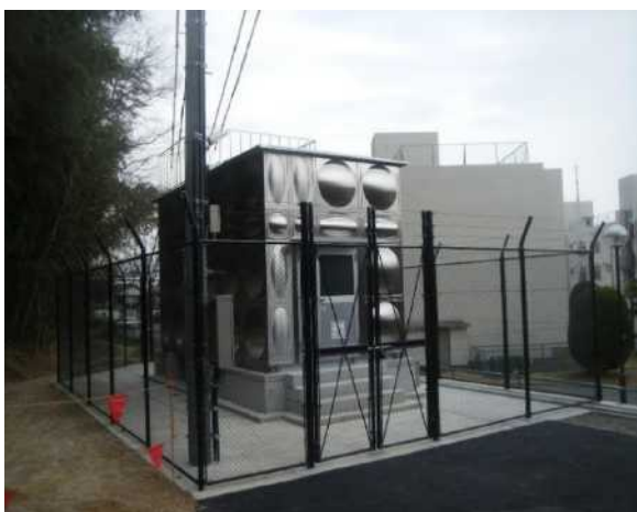
尾津一の谷団地ポンプ所
