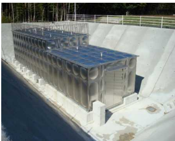
愛宕加圧設備
