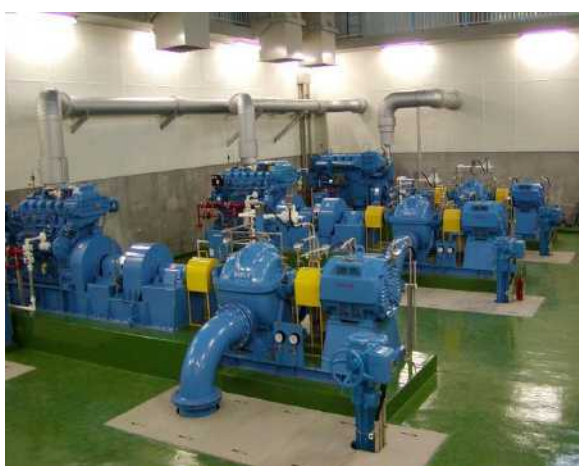
原水ポンプ室
