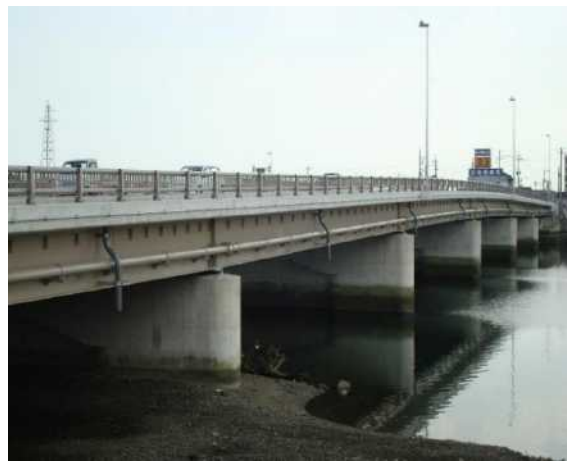
新寿橋添架配水管
