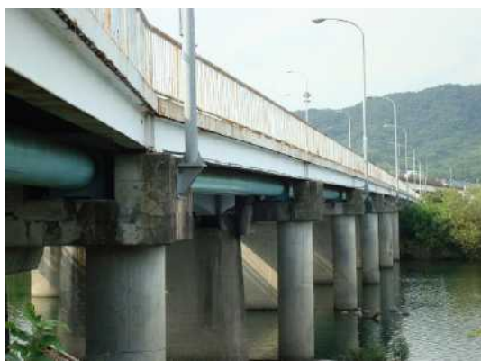
愛宕橋添架配水管
