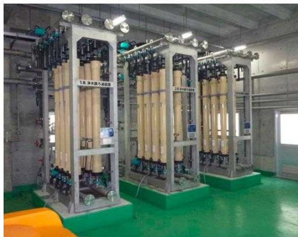
美和東部浄水場膜ろ過機
