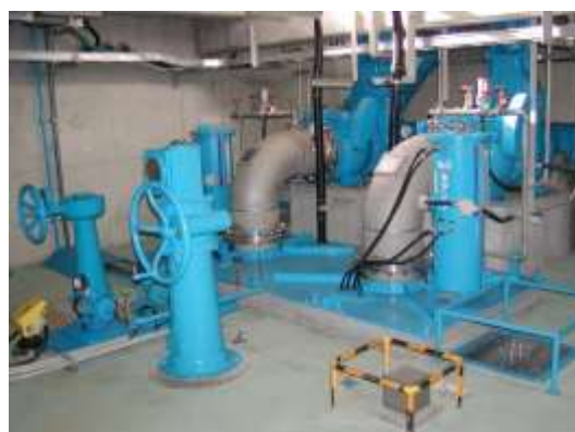
送水ポンプ室
