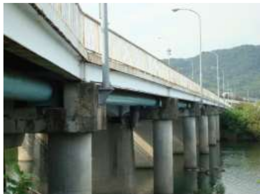
愛宕橋添架配水管
