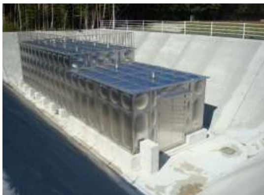
愛宕加圧設備
