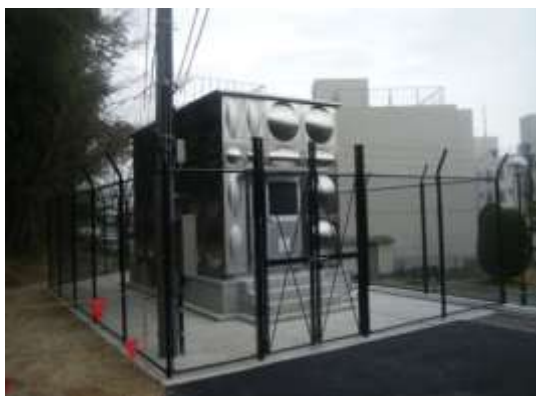
尾津一の谷団地ポンプ所
