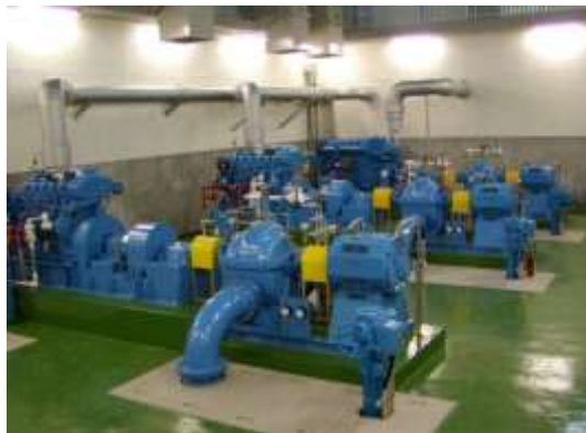
原水ポンプ室
