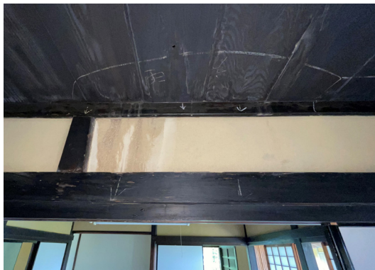
図 2-4-3 長押・鴨居・天井板の腐朽
