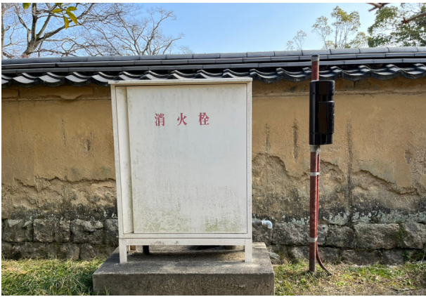
図 1-5-15 屋外消火栓設備と屋外侵入監視装置
