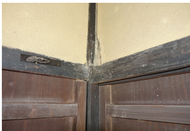
図 1-5-4 中間部屋壁剥離・鴨居抜け・壁チリ
