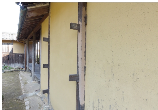
図 1-5-5 表面塗布剤の劣化
