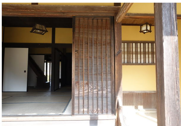
図 1-5-6 式台建具損傷
