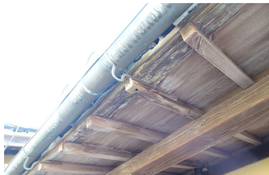
図 2-4-2 軒回りの腐朽
