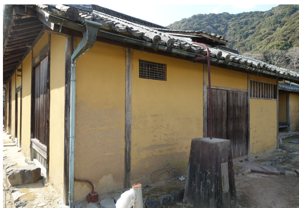
図 1-5-2 土間外壁剥離
