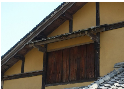
図 2-4-5 霧除板庇の腐朽
