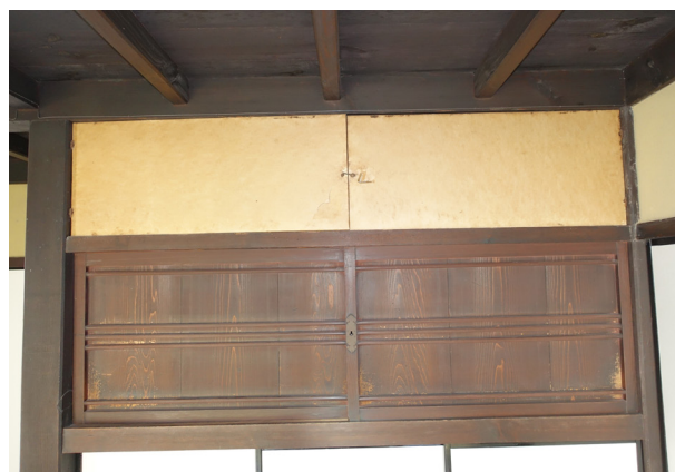
図 1-5-7 戸棚上段戸損傷
