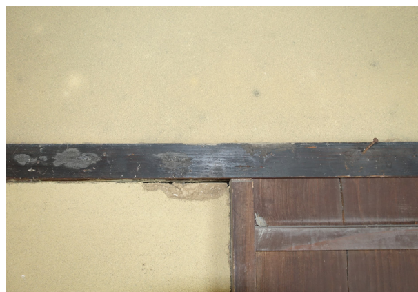
図 1-5-3 中間部屋壁剥離
