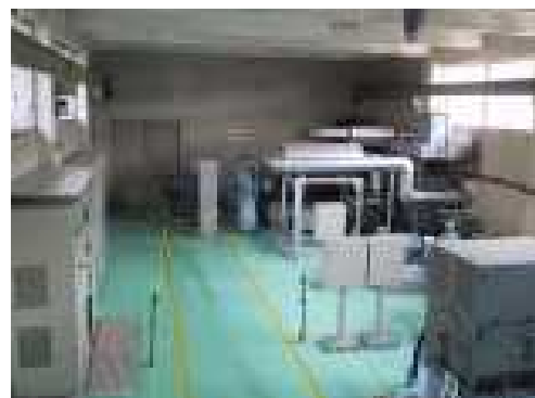
錦見送水ポンプ室
