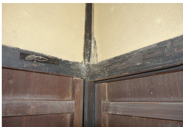
図 1-4-5 中間部屋壁剥離・鴨居抜け・壁チリ
