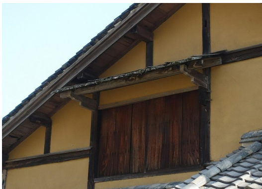
図 2-4-5 霧除板庇の腐朽
