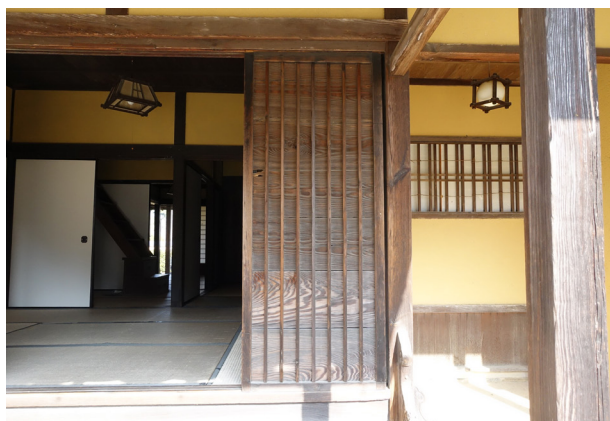
図 1-4-7 式台建具損傷
