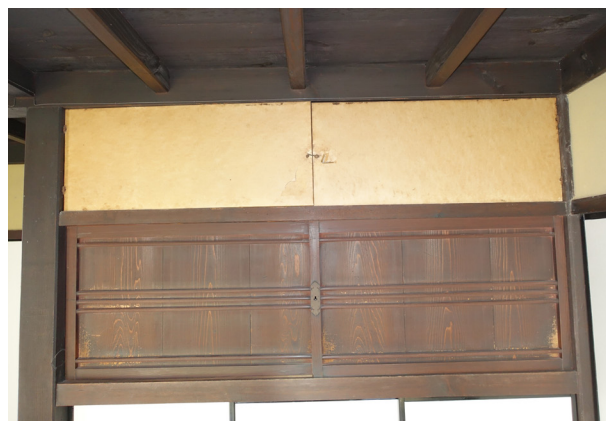
図 1-4-8 戸棚上段戸損傷
