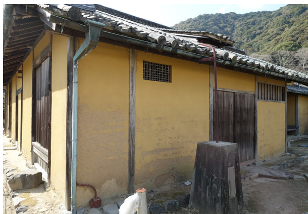
図 1-4-3 土間外壁剥落
