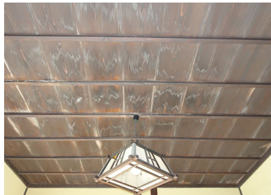
図 2-4-4 天井板の雨染み
