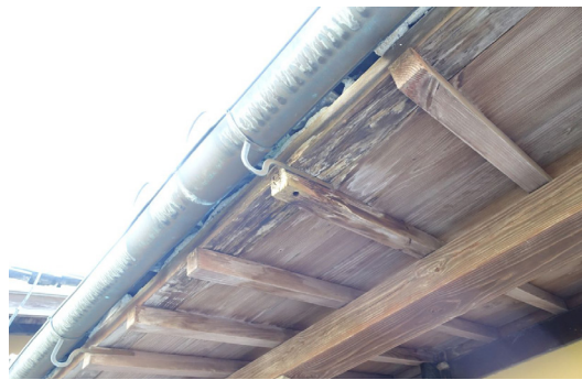
図 2-4-2 軒回りの腐朽
