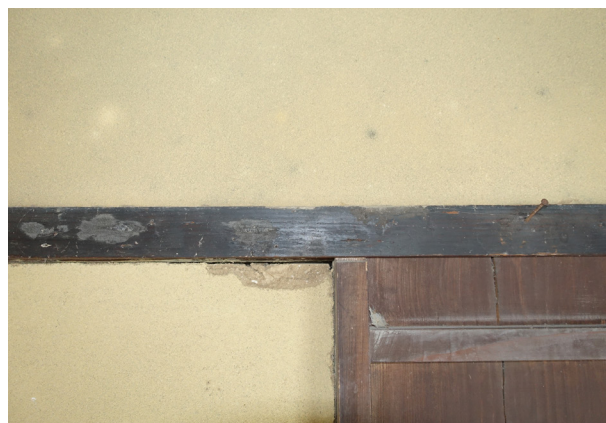
図 1-4-4 中間部屋壁剥離
