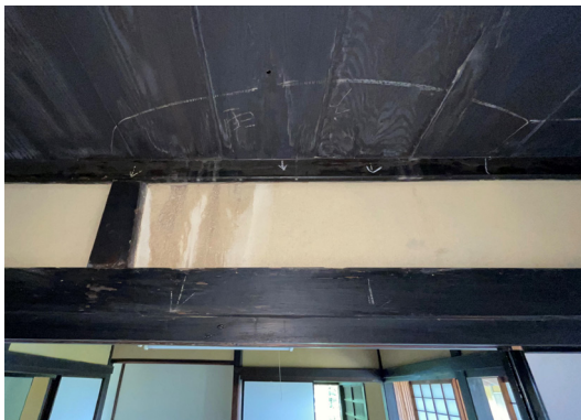
図 2-4-3 長押・鴨居・天井板の腐朽
