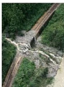
錦川鉄道の土砂崩れ
