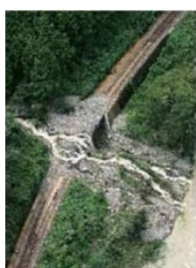
錦川鉄道の土砂崩れ
