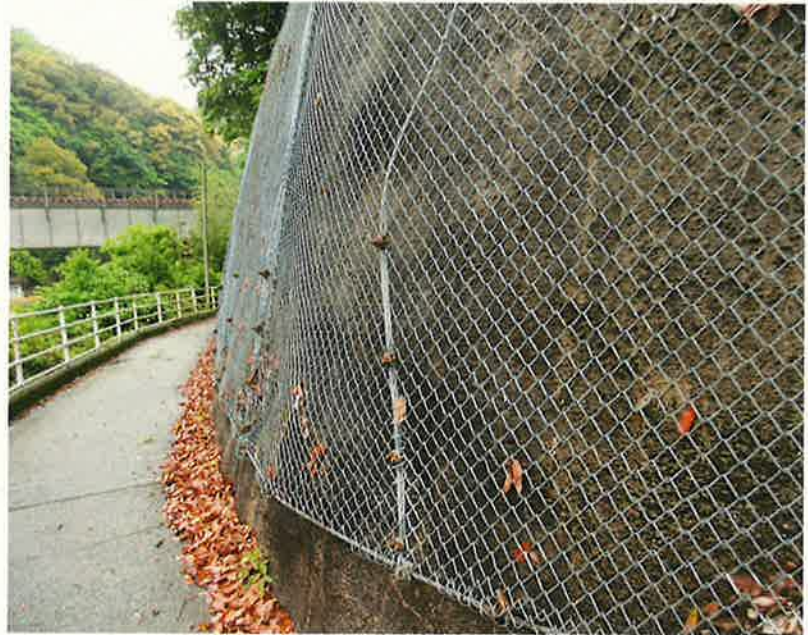
No1 ワイヤーが緩んでいる
