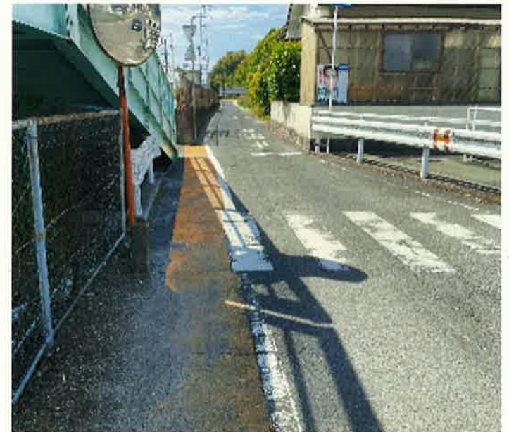
No 6 雨天時、横断歩道付近に水たまりができる
