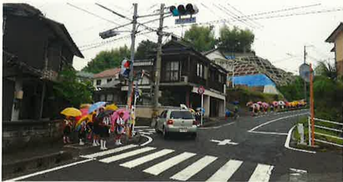
No 2 アスファルトの劣化・側溝のがたつき
