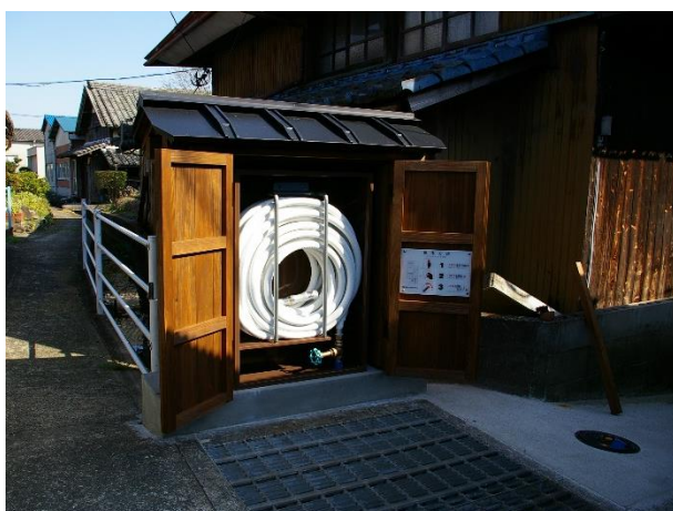
消防設備イメージ (易操作性1号消火栓 事例：佐賀県鹿島市)
