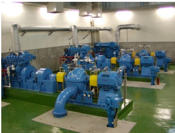
原水ポンプ室
