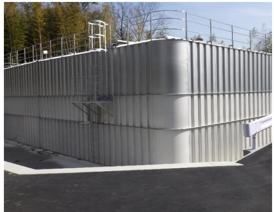
牛野谷配水池
