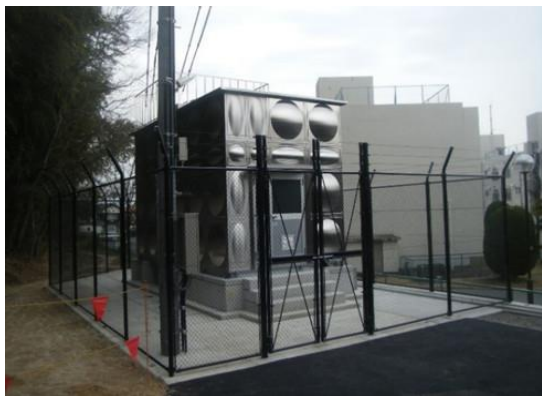
尾津一の谷団地ポンプ所
