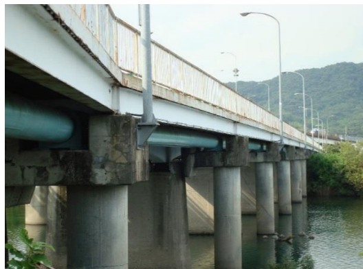
愛宕橋添架送水管
