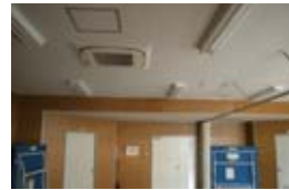
供用会館空調設備等整備 3,959万円
