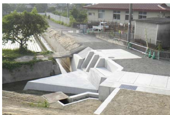
上市上地区南ポンプ場
