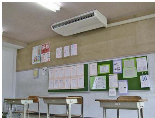
（空調設備整備例）
