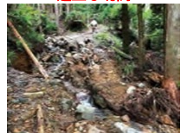
谷に盛土した作業道の崩壊
