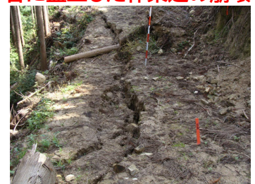
盛土で発生したクラック
