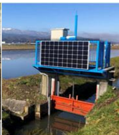
ソーラー式電動ゲート
