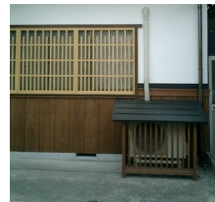
室外機の目隠し実施例
