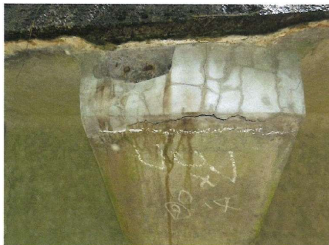
< Ⅱ 評価相当の損傷状況（鉄筋露出） >
