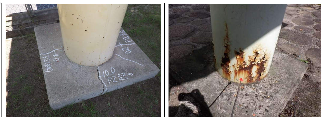
＜下部構造の損傷状況＞
