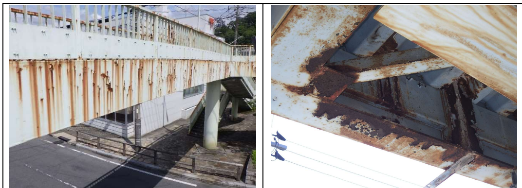
＜上部構造の損傷状況＞
