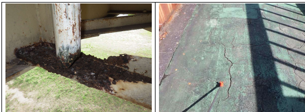
＜その他の損傷状況 左：排水樋の腐食、右：舗装のひびわれ・浮き＞
