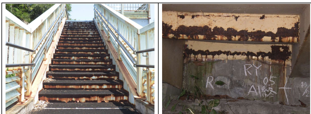
＜階段部の損傷状況＞
