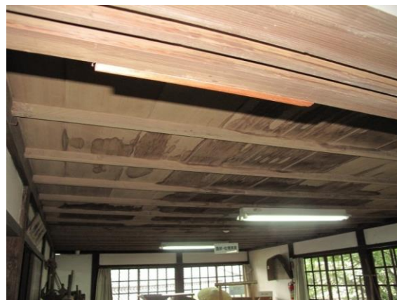
▲過去の雨漏りの様子
