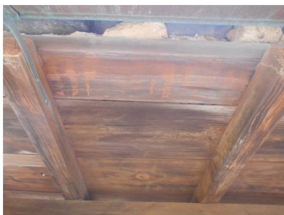
▲瓦下の赤土の老朽
