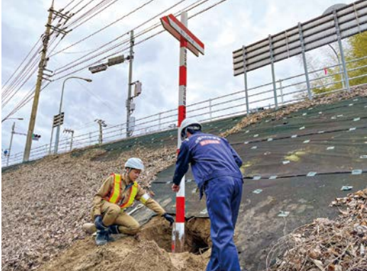
藤生長野バイパスに、道路の中心位置を示す中心表示杭を3月上旬から設置している
