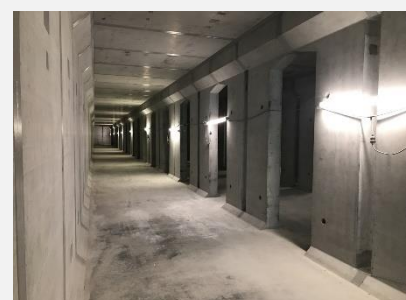
■一文字雨水調整槽 [内部]
