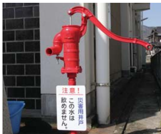
▲設置された災害用井戸
