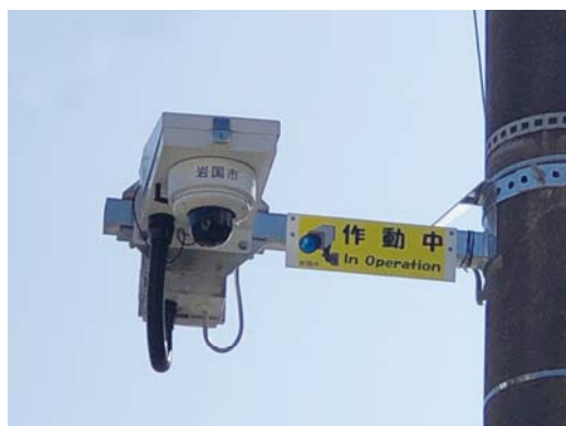
防犯カメラで撮影したデータは、プライバシーに配慮した適切な管理・運用を行う
