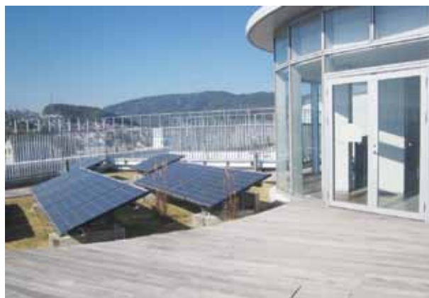
再生可能エネルギー（太陽光発電）の設置 (岩国市役所庁舎)
