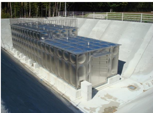
愛宕加圧設備
