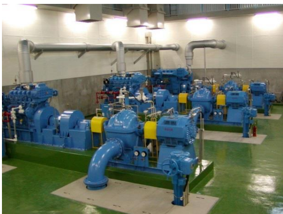
原水ポンプ室
