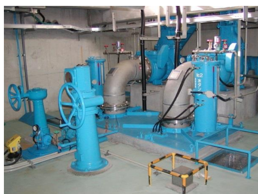
送水ポンプ室
