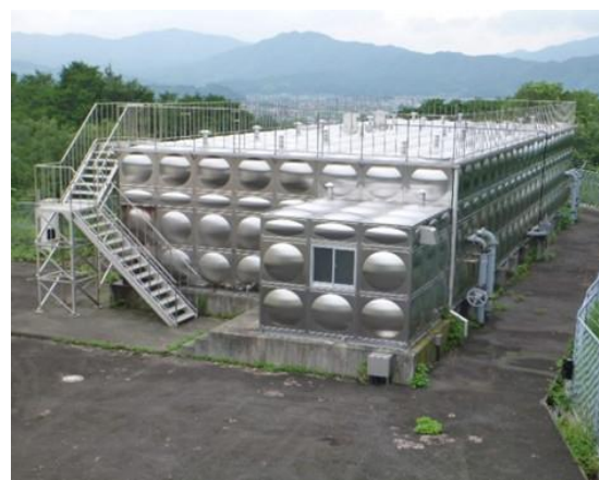
高森南配水池
