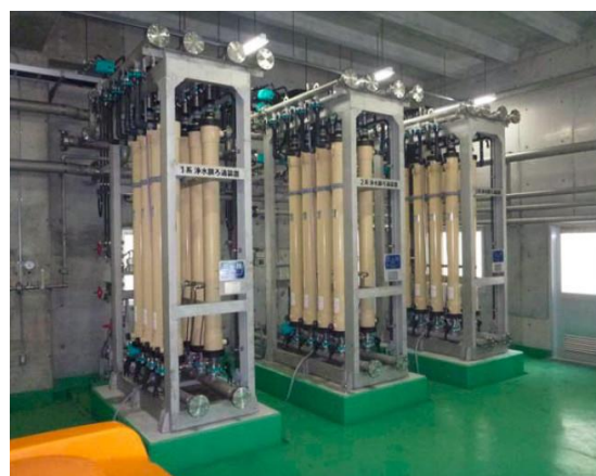
美和東部浄水場膜ろ過機
