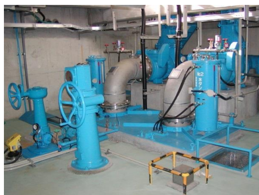
送水ポンプ室
