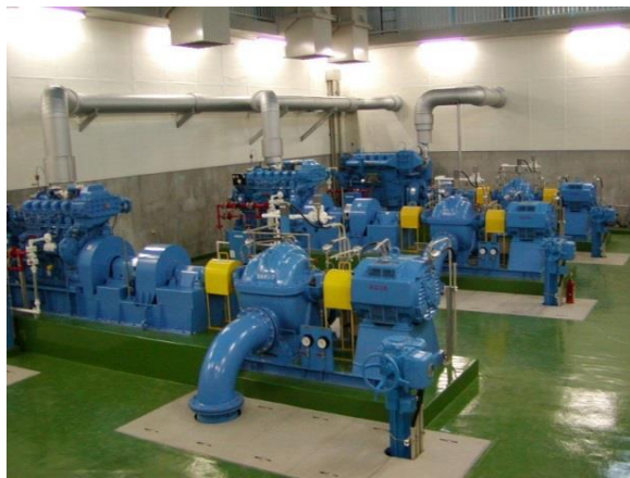
原水ポンプ室
