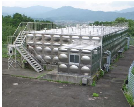
高森南配水池
