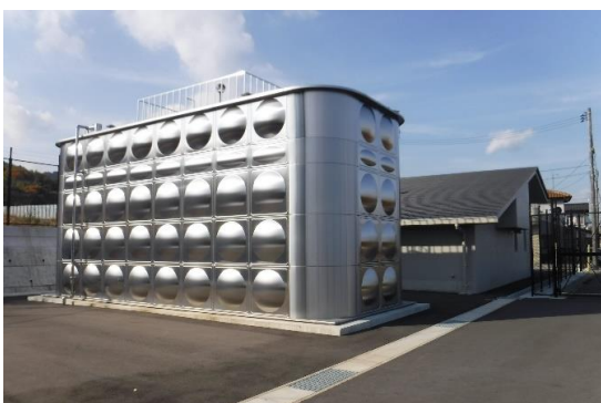
黒磯ポンプ所
