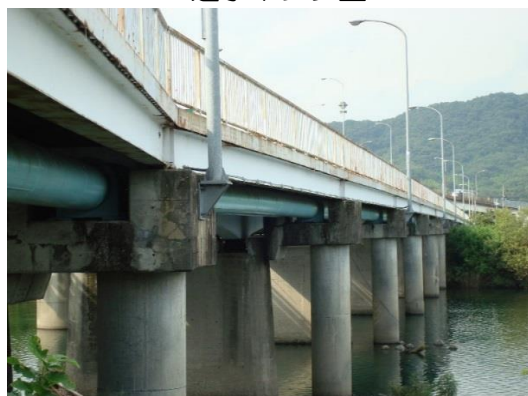
愛宕橋添架送水管
