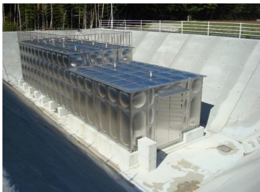
愛宕加圧設備
