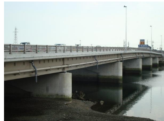
新寿橋添架配水管
