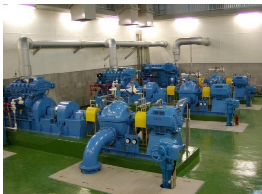
原水ポンプ室
