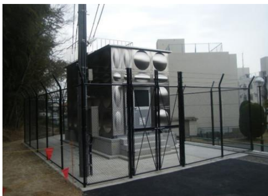
尾津一の谷団地ポンプ所
