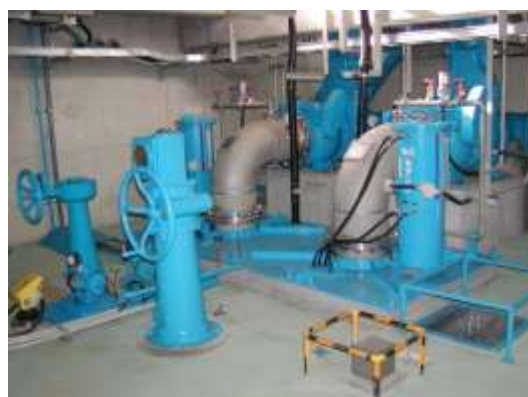
送水ポンプ室
