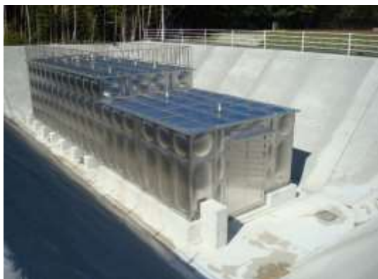
愛宕加圧設備
