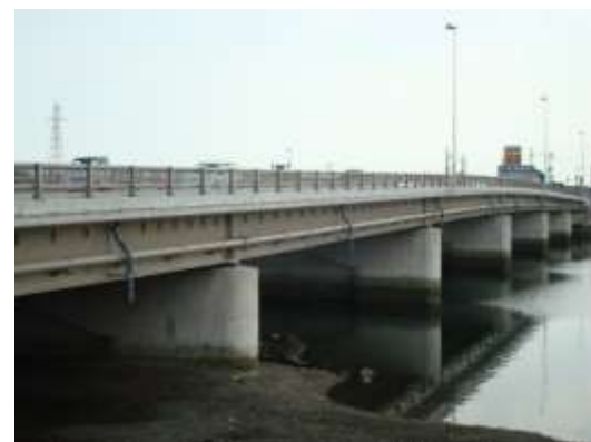
新寿橋添架配水管
