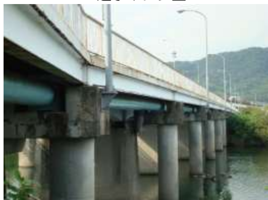
愛宕橋添架配水管
