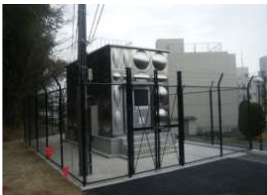
尾津一の谷団地ポンプ所
