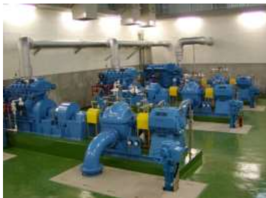
原水ポンプ室
