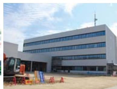
▼防災センター現場写真
