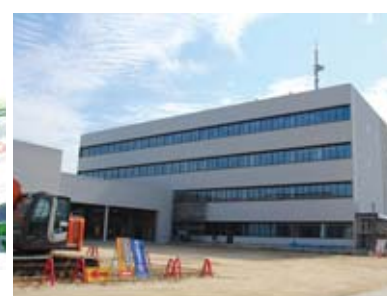
▼防災センター現場写真
