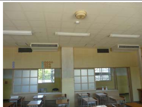
空調設備整備例
